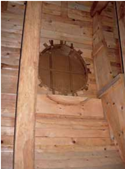
Obr. 10 Okrasné okno zvnútra chránené proti prístupu hmyzu a výstužové rebro debnenia kupoly – veža č. 1
