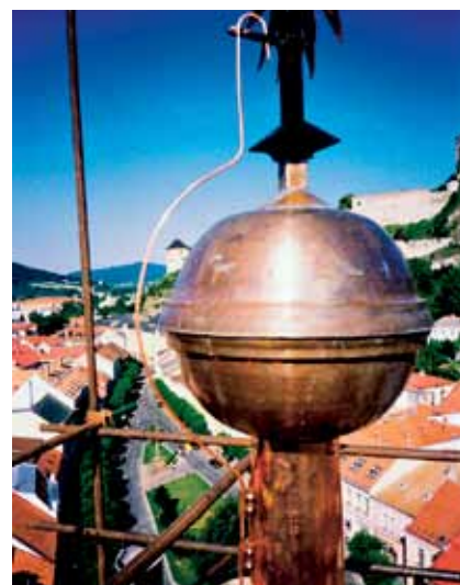
Obr. 9 Bleskozvodné premostenie makovice [8]
